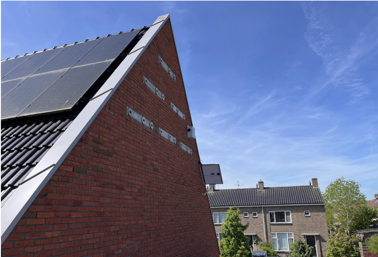
Figuur 3.2 Geluidsdrager met bijbehorend zonnepaneel aan een kopgevel.
